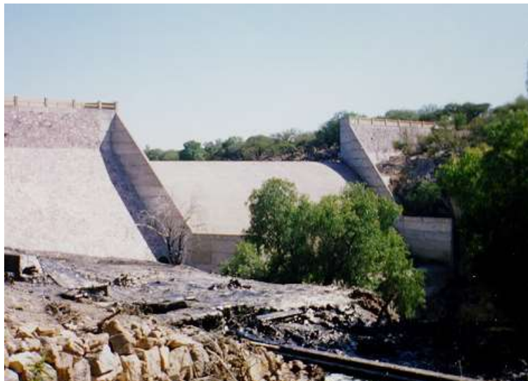
Figura 2.8 Vertedor con caída en rápida de la Presa El Niágara, Ags., CNA.
