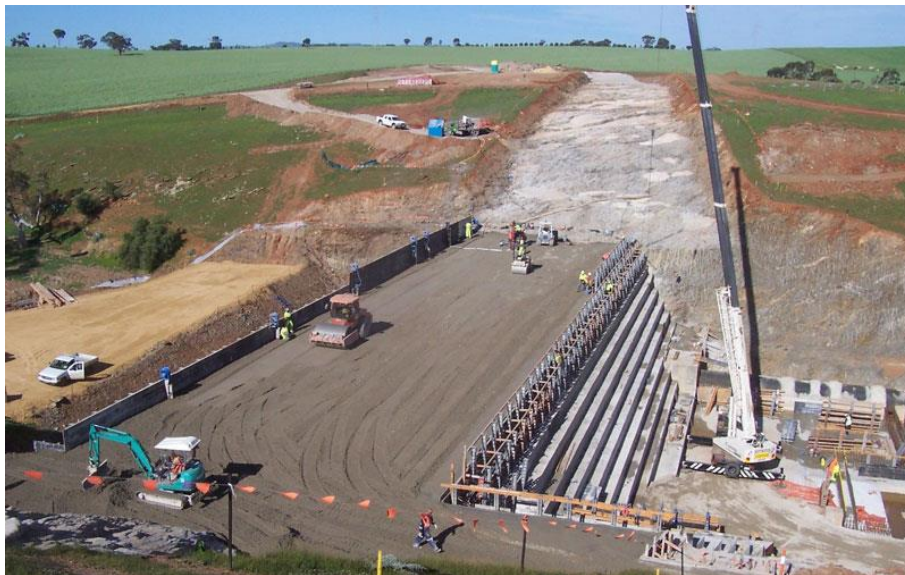
Fotografía 16. Vertedor escalonado de Concreto Compactado con Rodillo en la presa de control del río North Para.
