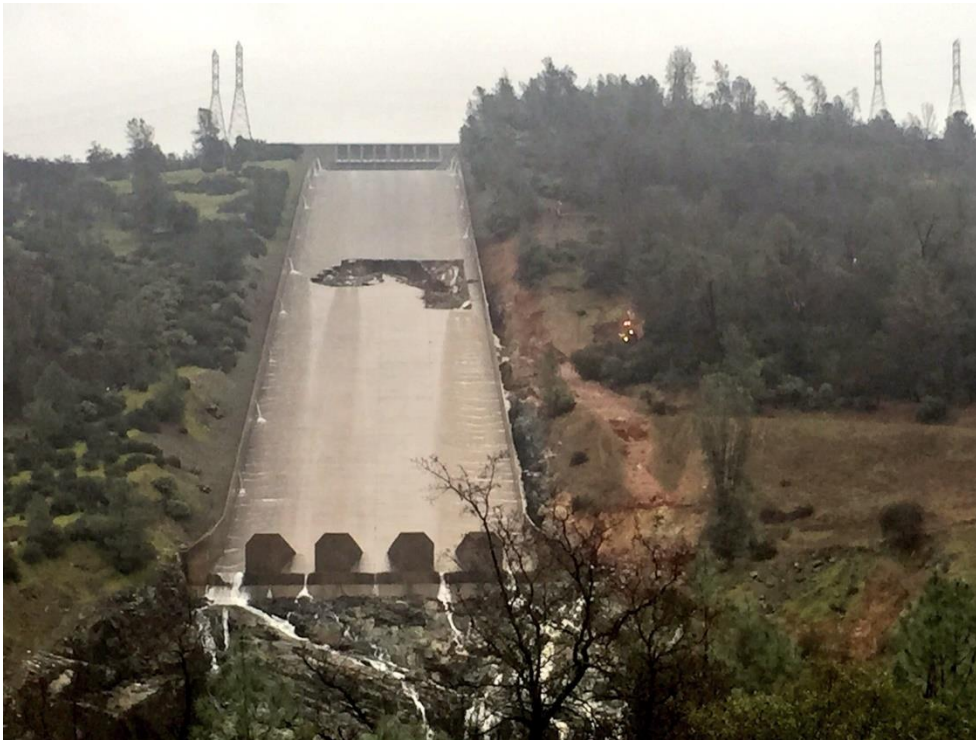
Fotografía 13. Vertedor de la presa de Oroville, después de sufrir daños ocasionados por un problema de cavitación.
