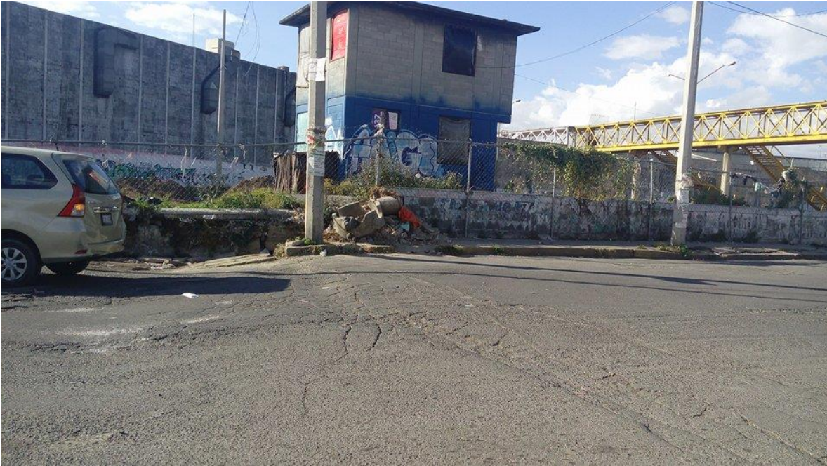
La imagen es sobre la calle Sentimientos de la Nación, el desnivel fue resultado de la grieta que atraviesa todo el predio y del terremoto del 19 de septiembre
