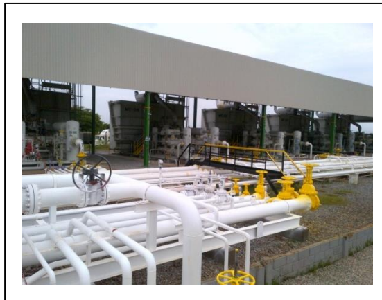
Fig. 6. Compresoras vista de líneas de succión y descarga de gas
