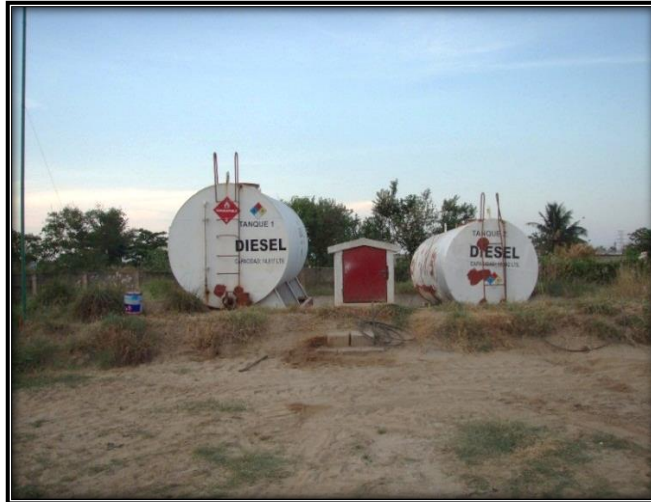
Imagen 25. Tanques de almacenamiento de combustible dentro de un dique.
