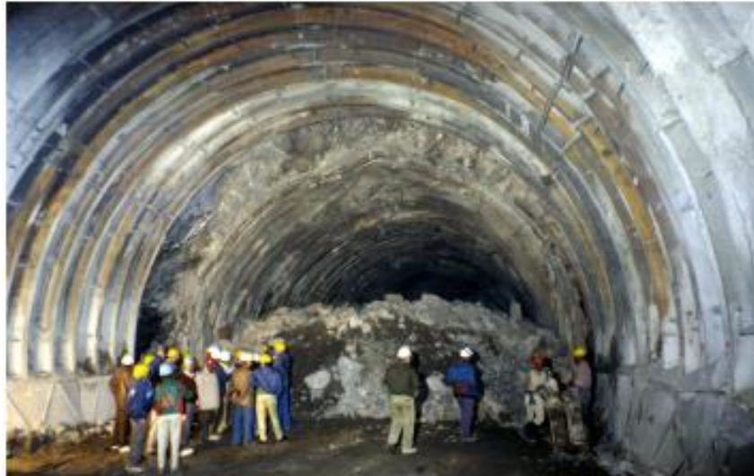
Figura 16. Hoek, E. & Marinos, P. (2000). Problemas con squeezing en túnel de 10 m a través de una zona de falla, con 1 m de desplazamiento hacia el interior. [Figura] Recuperado de “Predicting tunnel squeezing problems in weak heterogeneous rock masses”.
