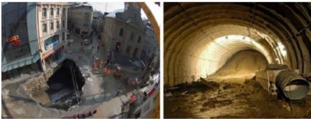
Figura 24. Jiménez, A (2016). Colapso del metro Lausanne, Suiza en 2005. Recuperado de Sistemas de Presostenimiento para Túneles en Terreno Difíciles.
