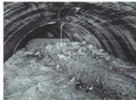
Figura 15. Zingg, Sara; Anagnostou, G. (2012). Entrada de agua y lodo durante la construcción de túnel de la central eléctrica Engadine. [Figura]. Recuperado de ETH Zürich Research Collection
