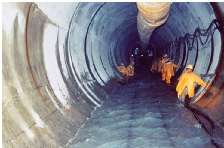
Figura 9. Inundación parcial, Túnel Walgau. Fuente: AMITOS.
