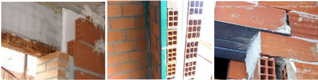
Figura 10. Ejemplos de piezas de mampostería no permitidas por las NTCM 2017
