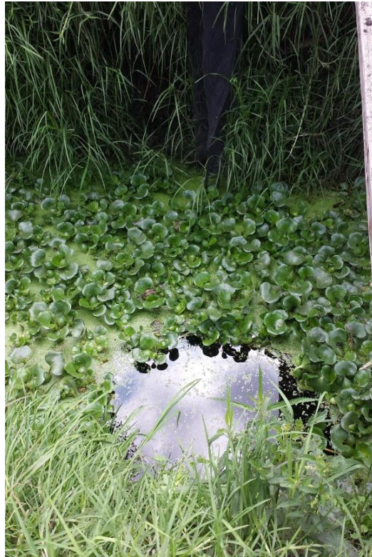
Imagen 6. Obstrucción de apantle por lirio acuático.
