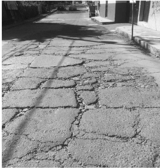
Imagen 3.10.- Desgaste de la carpeta asfáltica con agrietamiento superficial.
