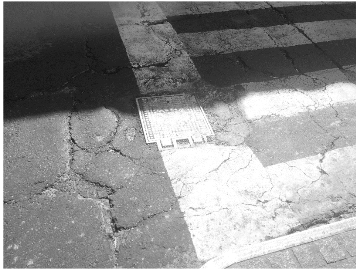
Imagen 3.7.- Registro ubicado en la calle 20 de noviembre esquina con Emilio Carranza.
