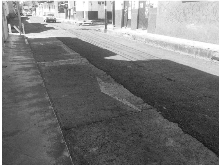
Imagen 3.8.- Mal colocación de carpeta asfáltica.
