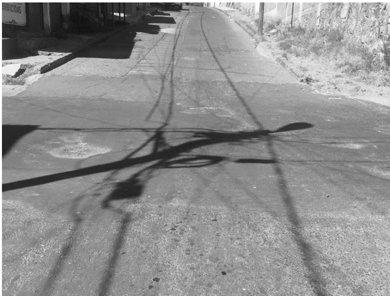
Imagen 3.11.- Irregularidad en la superficie de rodamiento.
