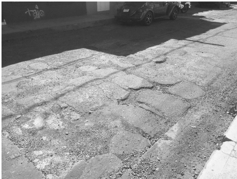
Imagen 3.9.- Fracturas y orificios en la superficie de rodamiento de la calle.
