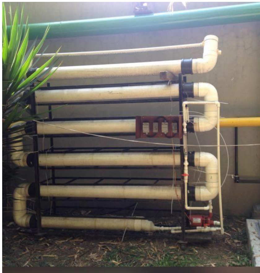
Figura 5. Reactor Biológico Tubular (RBT) instalado en Planta de Tratamiento de Aguas Residuales Ciudad Universitaria
