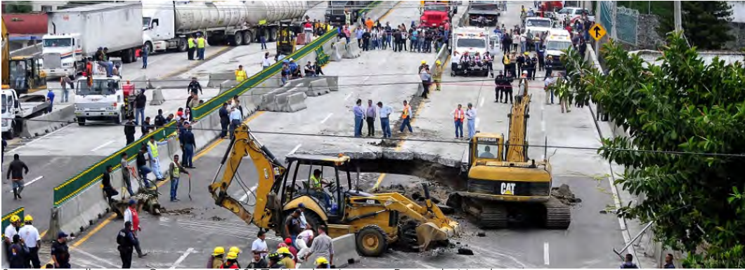
Socavón por lluvias en Cuernavaca, 2017, Morelos. Imagen: Diario de Morelos
