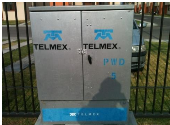
Fig. 7. Caja de Distribución o Distrito. Fotografía propiedad del autor de la Tesis
