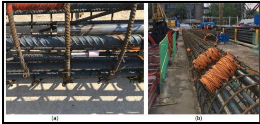
Figura 52.- (a) Deformímetros para concreto (“sister bar”) (b) Cables de los sensores (carretes)
