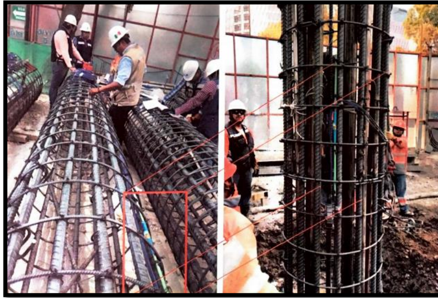
Figura 22.-Deformímetros de cuerda vibrante (sister bar) amarrada con alambres al acero de refuerzo principal de una pila de prueba (CIMESA)
