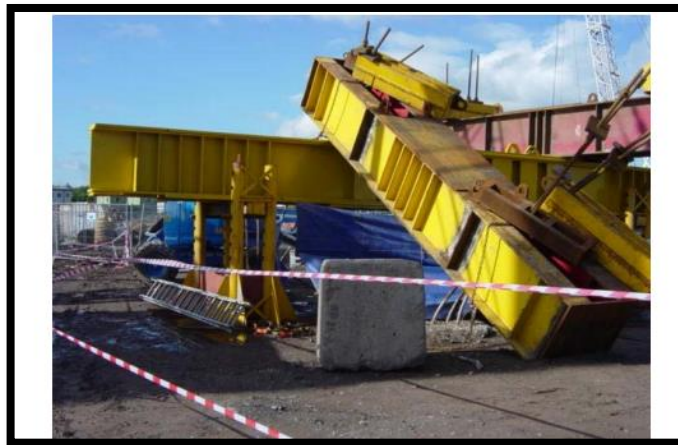
Figura 2.-Fallo del sistema de reacción en la pila de prueba (Handley & Bullivant, 2006)
