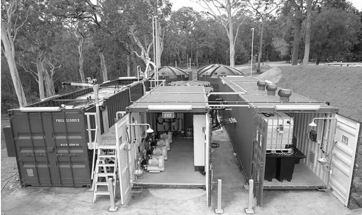
Figura 6.7c. Plantas de tratamiento en contenedores (Biomicrobe Technology, 2018)
