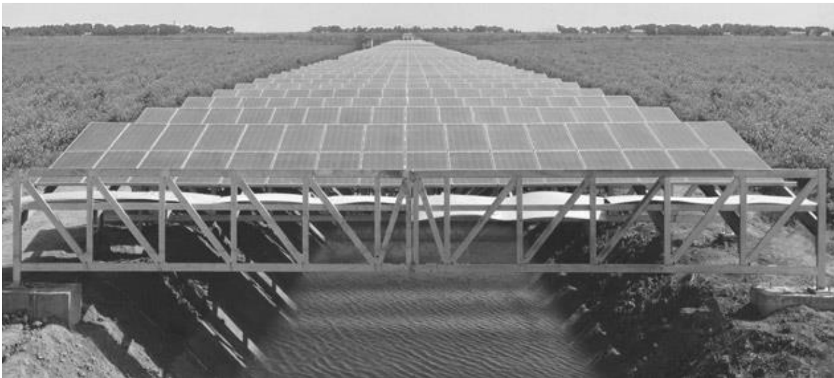
Figura 6.3b. Sistemas fotovoltaicos en canales de irrigación (SolarEnviro. 2014)
