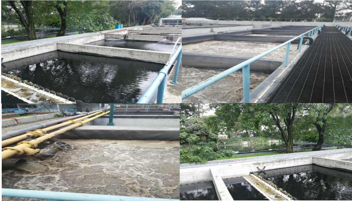
Figura 26 PTAR Ciudad deportiva
