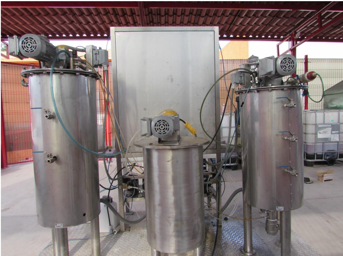
Figura 4.5.2 Planta piloto: reactor acidogénico CSTR, tanque de igualación y reactor metanogénico UASB.
