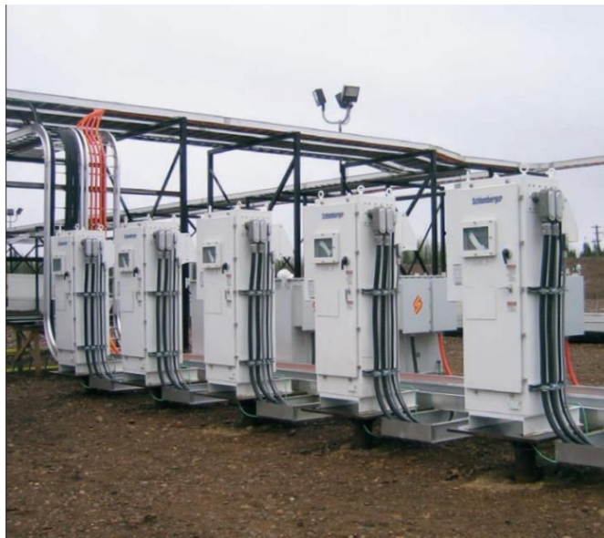
Figura 20. Variador de velocidad (VSD)
