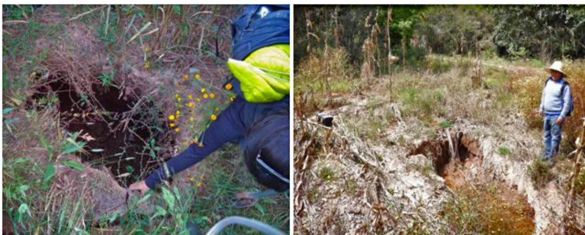
Figura 6.4 Formación de socavones asociados a tunelamiento subsuperficial en lamabordo del sistema Tooxi, MIX 03.
