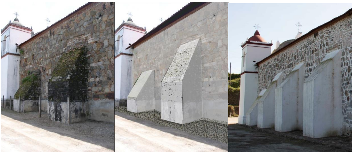
Fachada oriente del templo de Yatzachi el Alto, se observan las acciones de intervención propuestas: erradicación de flora parasita, encalado muro y contrafuertes y banqueta perimetral. Las imágenes muestran la siguiente secuencia: estado en 2010, proyecto de restauración 2011, estado en 2015.
