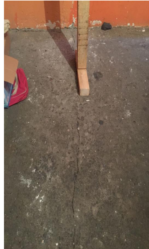
Grieta en recámara principal
