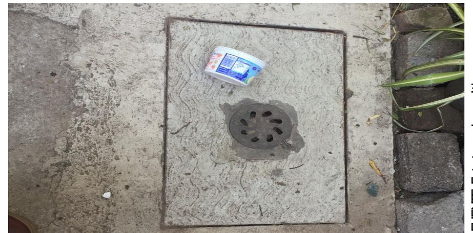
Registro de drenaje
