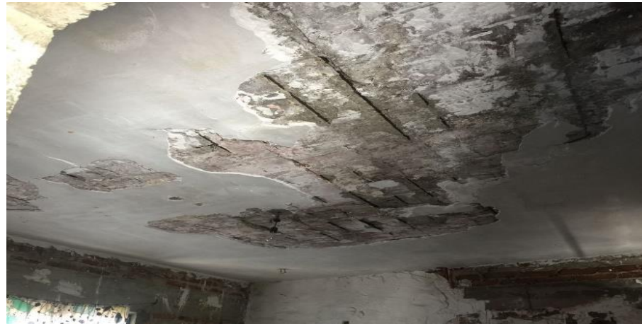
Losa desgastada, hecha de concreto armado
