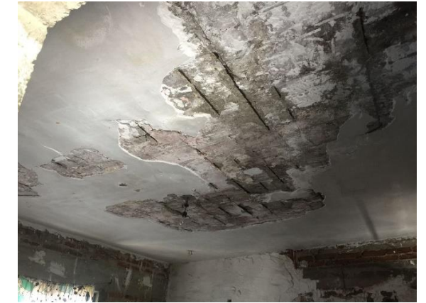
Desgaste de losa
