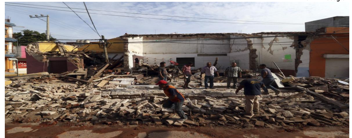
VIVIENDA DESPUÉS DEL SISMO FUENTE: Google
