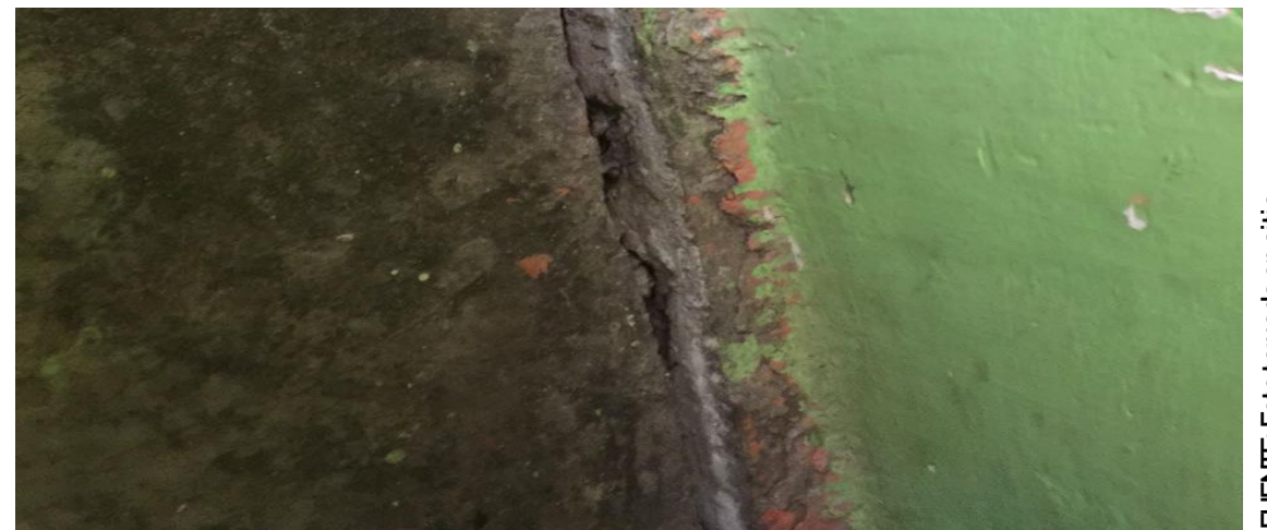
Grieta en recámara
