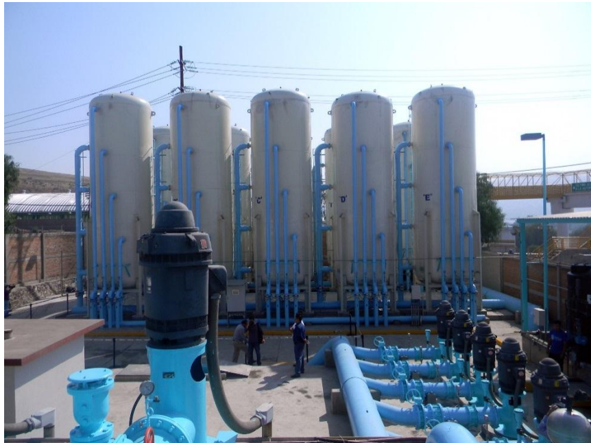
Figura 4.8 Filtros a presión de arena y carbón activado
