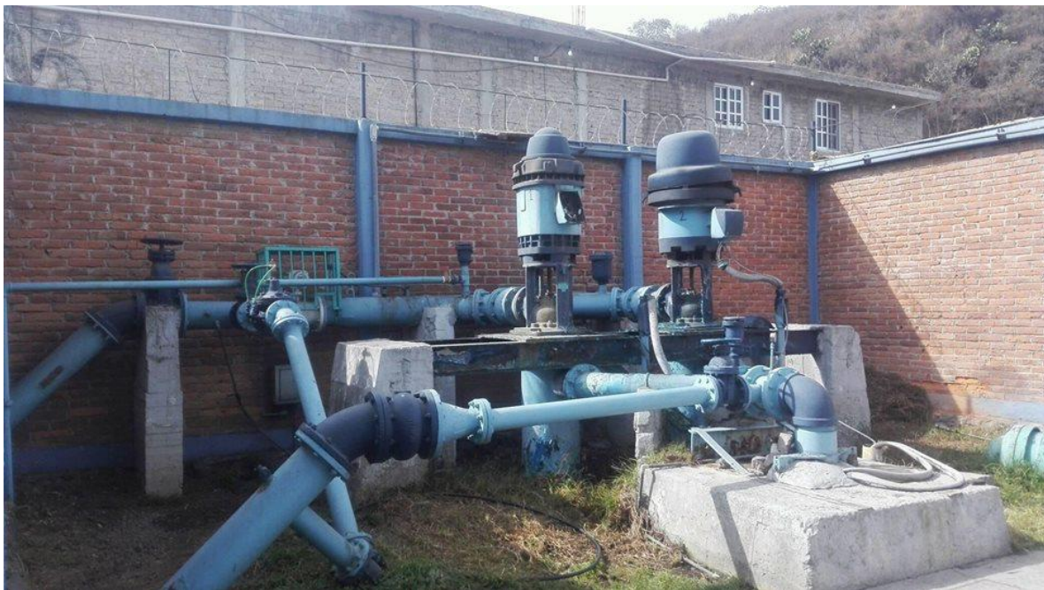
Ilustración 18: Bombas conectadas en paralelo con potencia de bombeo de 120HP - 150HP.
