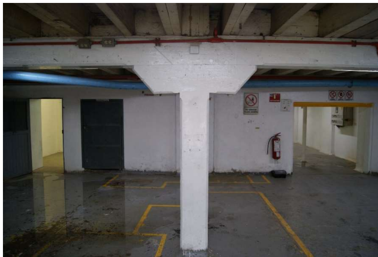
Figura 122. Archivo M.A.R.C. Los deterioros que cuenta este conjunto estructural, es manchas, por humedad, hundimientos y perforaciones por colocación de agregados para instalación eléctrica.
