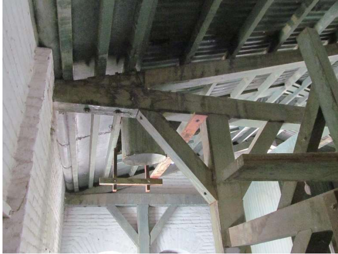
Figura 114. Archivo M.A.R.C. parte de la armadura de madera que soporta la cubierta en la crujía norte. Se ven las uniones de acero. Manchas de húmedas por la filtración de agua pluvial.
