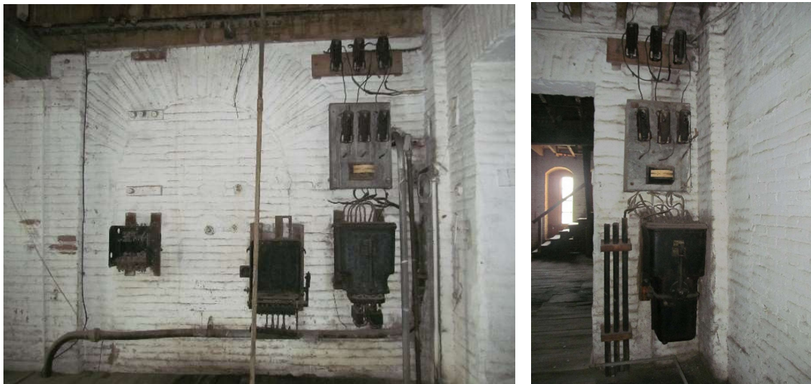
Figura 60 y 61. Archivo M.A.R.C. Interruptores y tableros de energía de finales del siglo XIX
