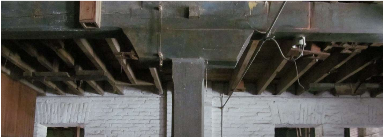
Figura 121. Archivo M.A.R.C. La columna, zapata y viga principal, muestra el desprendimiento de su probable pintura original, grietas a causa de las reacciones al clima extremo, y por la colocación de tuberías para instalación eléctrica.
