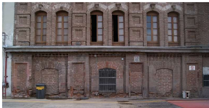
Figura 124. Archivo M.A.R.C. Fachada principal planta y segundo nivel. El mayor desgaste del ladrillo (tabique) se encuentra en el área que correspondería al rodapié del muro.
