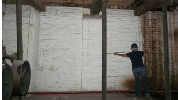
Figura 123. Archivo M.A.R.C. Muro interior poniente, a la extrema derecha, es donde muestra el mayor deterioro por la cargada filtración de agua pluvial por la mala condición de las canaletas.
