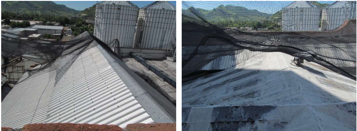
Figura 77 y 78. Archivo M.A.R.C. Cubierta a dos aguas de la nave correspondiente a la crujía sur (derecha). Cubierta de la crujía norte donde se ven las distintas pendientes por las buhardillas ubicadas en esta área. La cubierta también de lámina galvanizada y cubierta con elastomérico.
