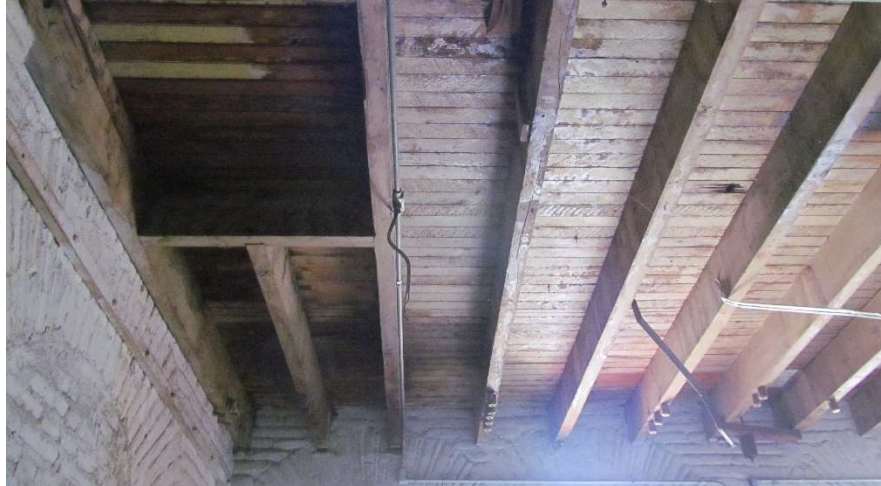
Figura 119. Archivo M.A.R.C. vigería del entresijo en el segundo nivel. Se aprecian las manchas por la humedad filtrada tanto por la azotea como por algunos vanos de ventanas. Casi al llegar al muro, se perciben las piezas de porcelana pertenecientes a la instalación eléctrica de inicios de siglo XX.
