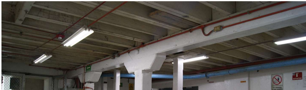
Figura 120. Archivo M.A.R.C. vigería en planta baja, probablemente con varias capas de pintura que ha sido colocada con el tiempo. Estas vigas han sido deterioradas por los agregados correspondientes a la instalación eléctrica.
