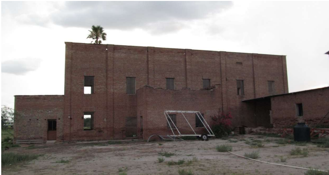
Figura 27. Estado actual del interior del molino de la antigua hacienda de Camou. Archivo M.A.R.C. año 2015. Este edificio era un molino harinero construido de ladrillo de media caña, su maquinaria funcionaba por medio de una turbina movida por energía hidráulica. Los mechinales son testigos de que existió un entrepiso de viguería de madera.
