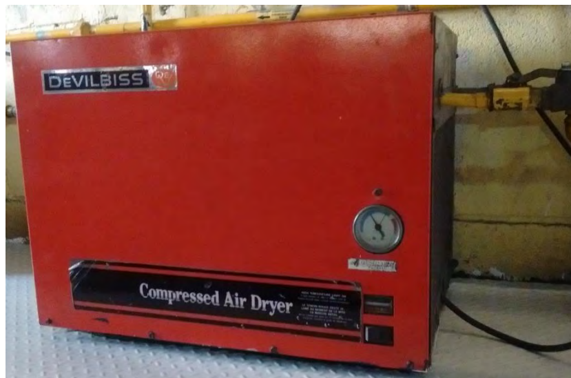
Figura 22. Secador de aire comprimido. Fotografía de la planta.
