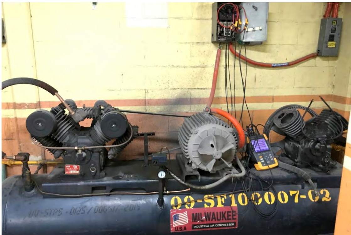
Figura 21. Compresor 3. Fotografía de la planta.
