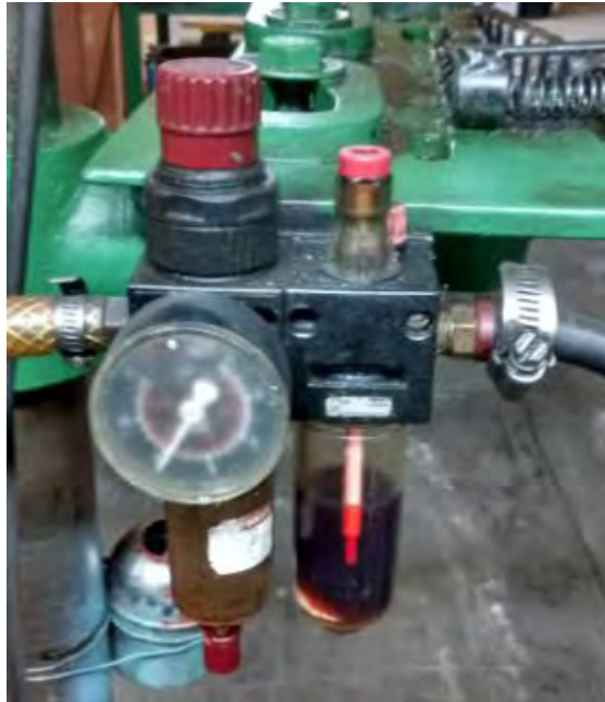
Figura 35. Unidad de mantenimiento, área de armado de quemadores. Fotografía de la planta.
