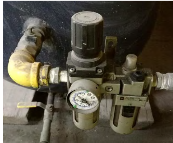
Figura 20. Filtro a la salida del compresor 3. Fotografía de la planta.
