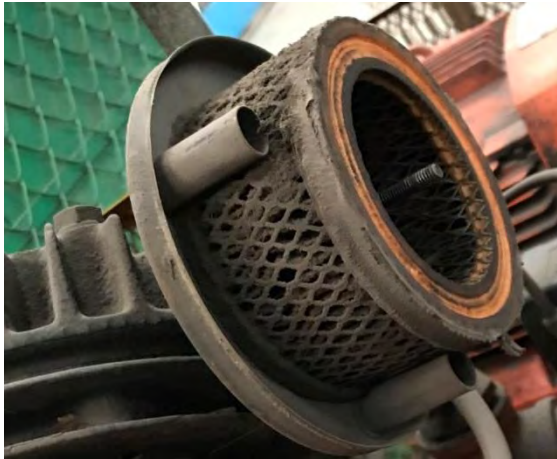
Figura 19. Filtro de entrada obstruido por el polvo, compresor 2. Fotografía de la planta.
