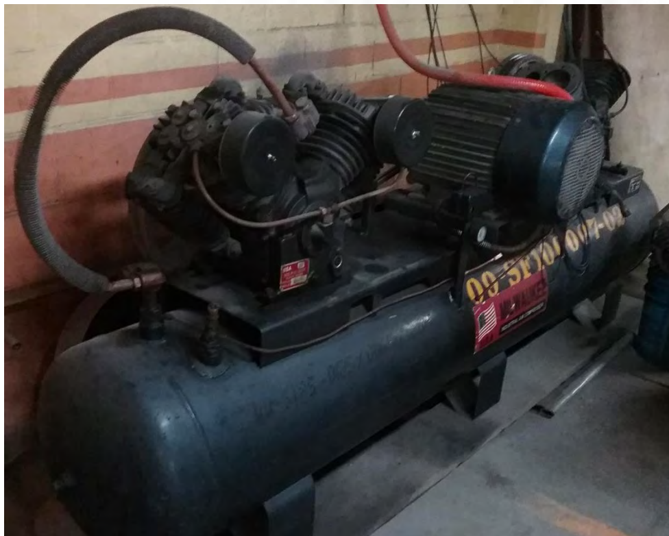
Figura 18 Compresor de 20 hp. Fotografía de la planta.
