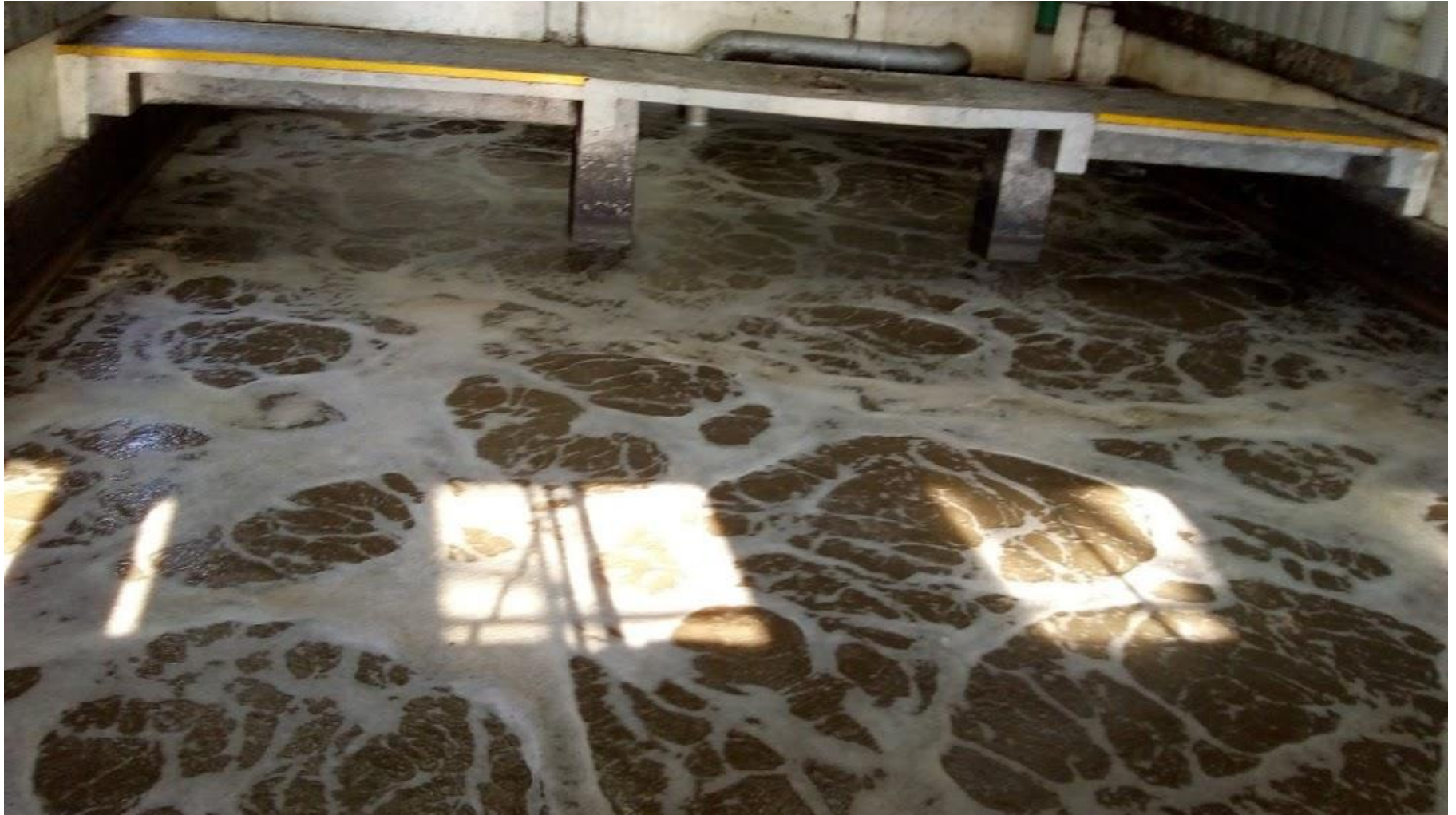
Figura A-9. Tanque de aeración de PTAR de Ciudad Universitaria.
