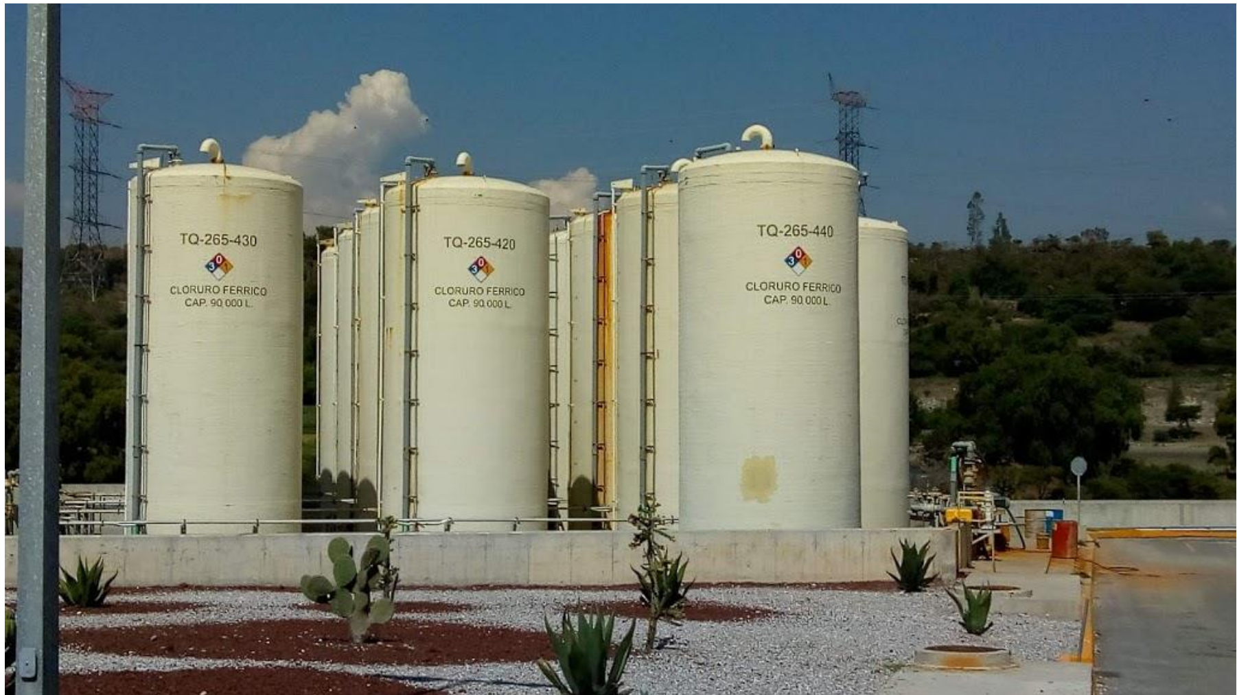
Figura A-15. Almacenamiento de coagulante en la PTAR Atotonilco de Tula.
