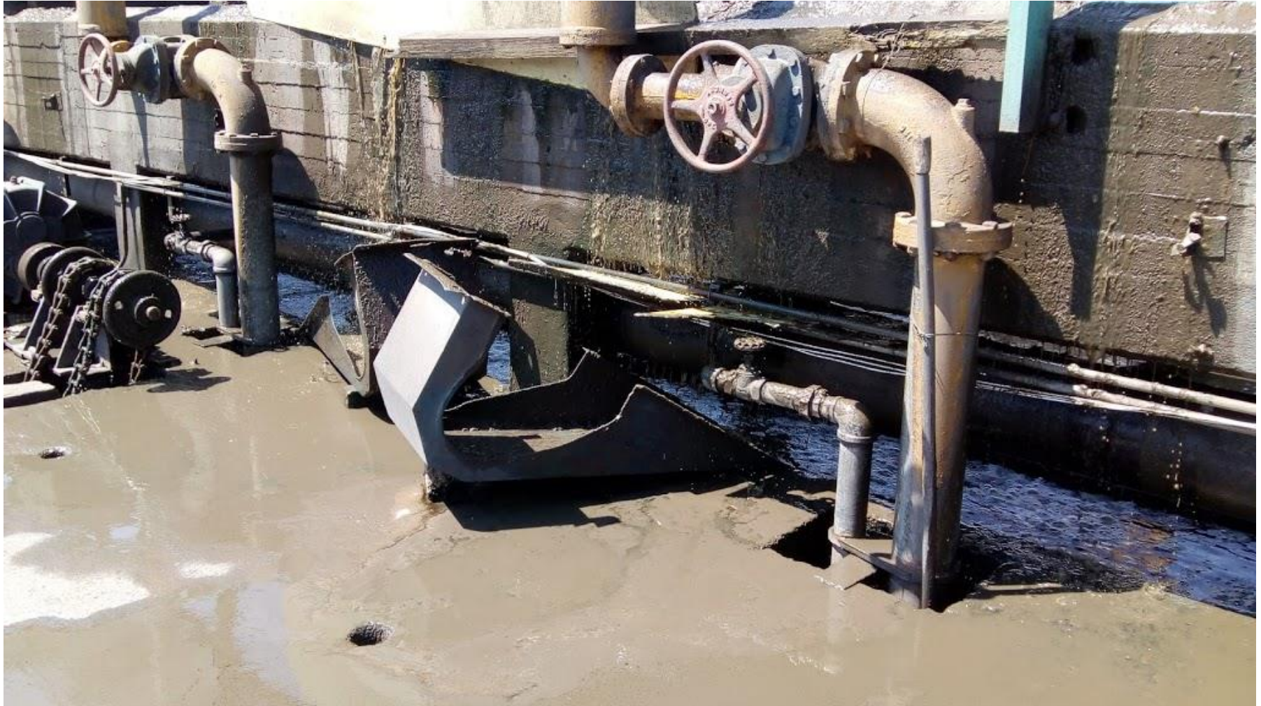
Figura A-11. Fuga de lodos en PTAR Cerro de la Estrella.
