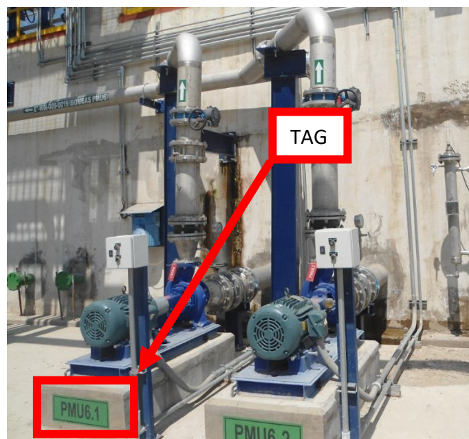
Figura 3.3 TAG de equipos en campo. Fuente: foto tomada por el autor.
