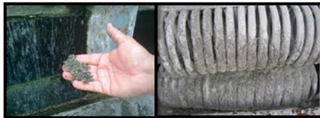
Figura 27 Incrustación en serpentín de condensador (Fotografía en campo)
