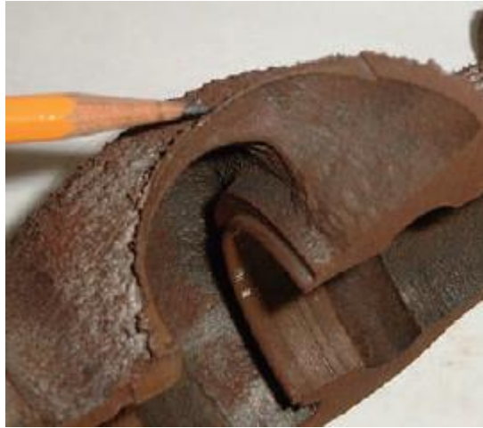
Figura 16 Erosión presente en una válvula de globo (ASHRAE, 2007)
