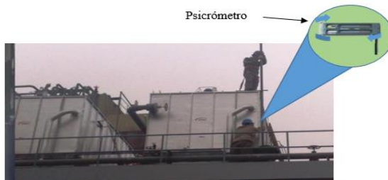
Figura 25 Toma de T_w y T para condensador
