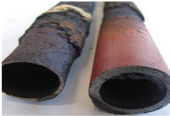
Figura 17 Tubería corroída por infiltración de humedad (ASHRAE, 2007)
