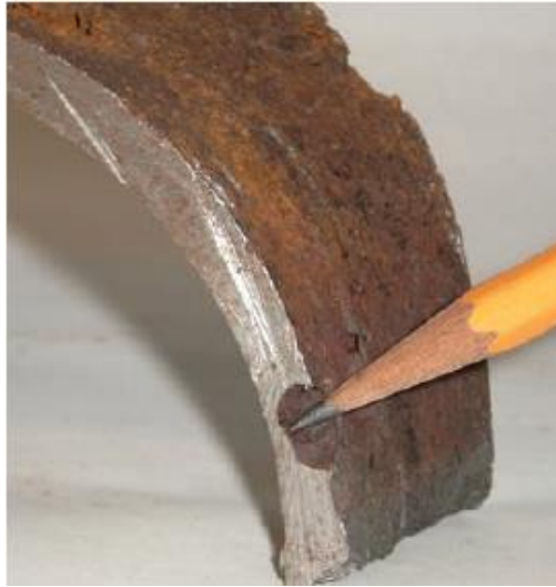
Figura 15 Picadura en tubería (ASHRAE, 2007)
