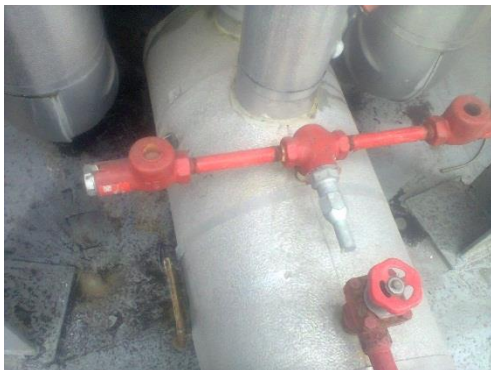
Figura 42 Válvulas sin línea de venteo (Fotografía en campo)
