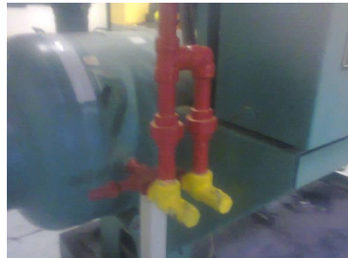
Figura 43 Tren válvulas de seguridad conectadas a línea de desfogue (Fotografía en campo)
