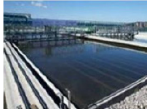
Imagen 161 .Sistema de tratamiento de agua
