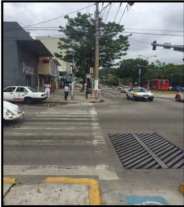
“Rejilla ubicada en entronque desde la Av. Cuauhtémoc y la calle Michoacán”.
