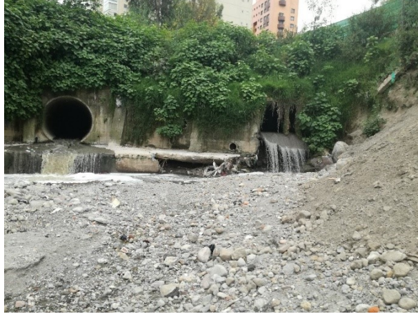
(a) Tuberías de la red (Vista hacia el suroeste).
