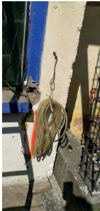
Imagen 23. Falla en muro.
