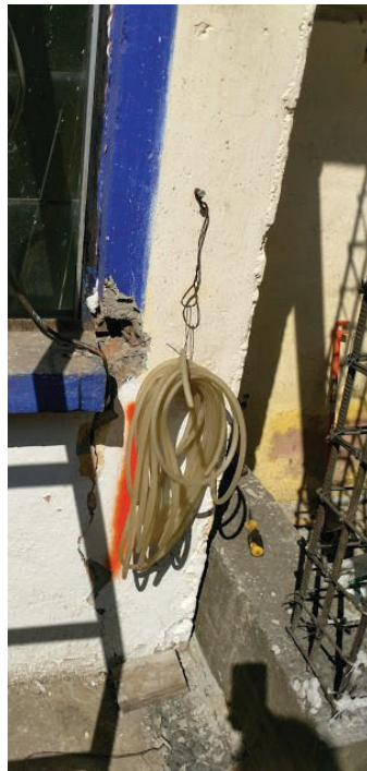
Imagen 23. Falla en muro.
