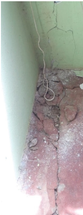
Imagen 22. Piso de la vivienda levantado a causa del sismo
