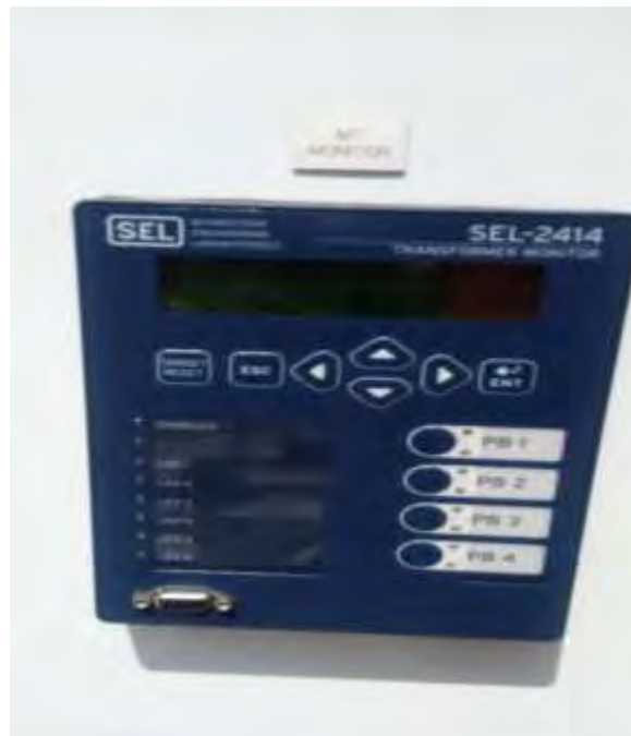
Figura E.3. Relé utilizado para el monitoreo de transformadores
