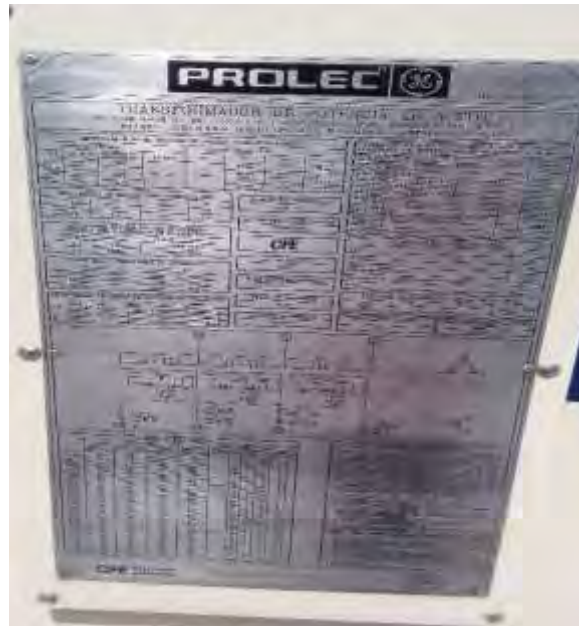
Figura E.2. Datos de placa del Transformador T1 y T2
