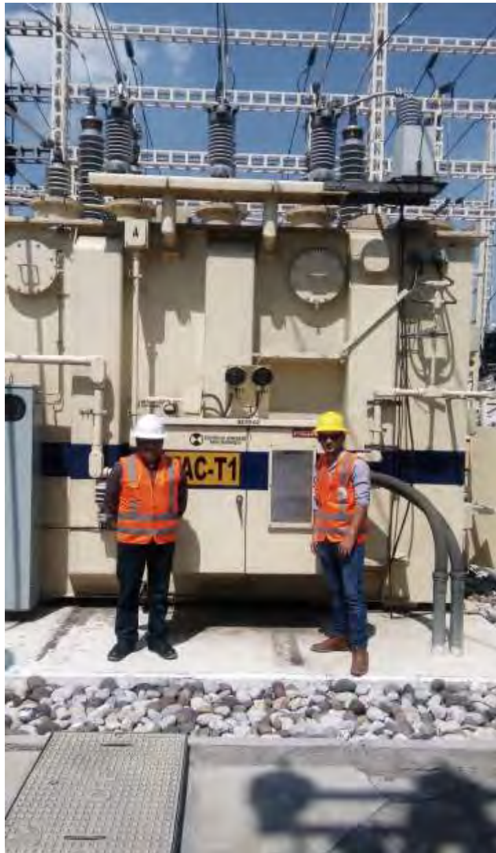
Figura E.1. Transformador T1
