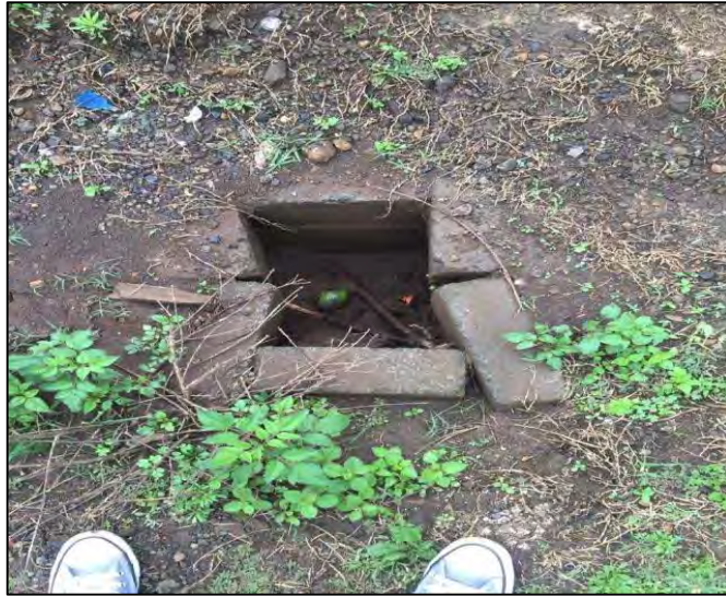
Fotografía 3.1.- Registros de servicio de agua potable.
