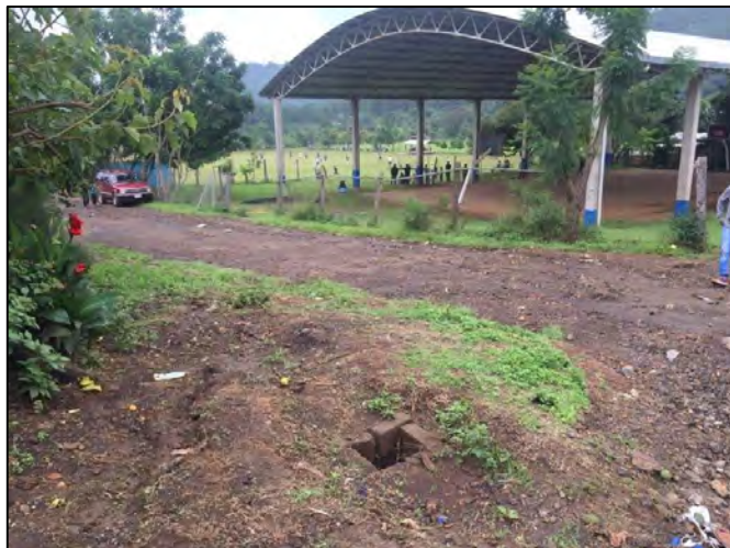
Fotografía 3.2.- Registros de servicio de agua potable.
