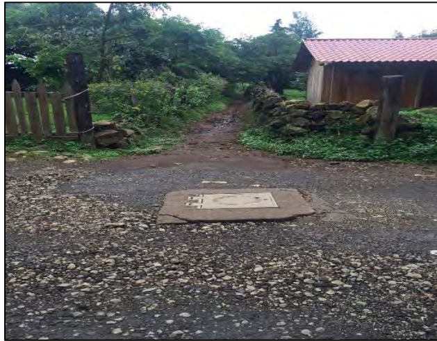
Fotografía 3.6.- Registro de línea de alimentación de agua potable.
