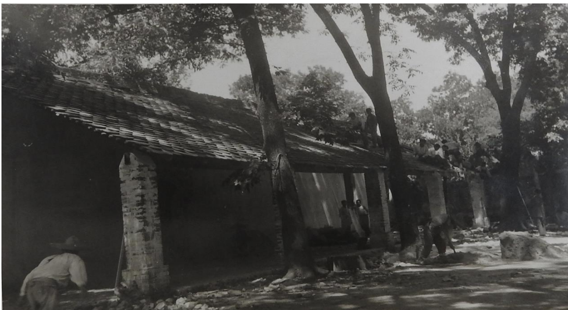
“PERSONAL DE LA ESCUELA FEDERAL. CONSTRUCCIÓN DE UNO DE LOS SALONES DE CLASE”
