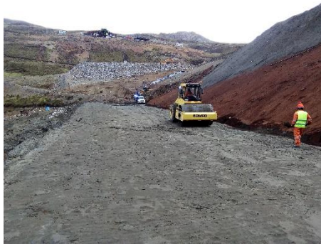
Figura 5.9: Trabajos de compactación en arenas de relaves con rodillo liso vibratorio (Nyrstar, 2017).
