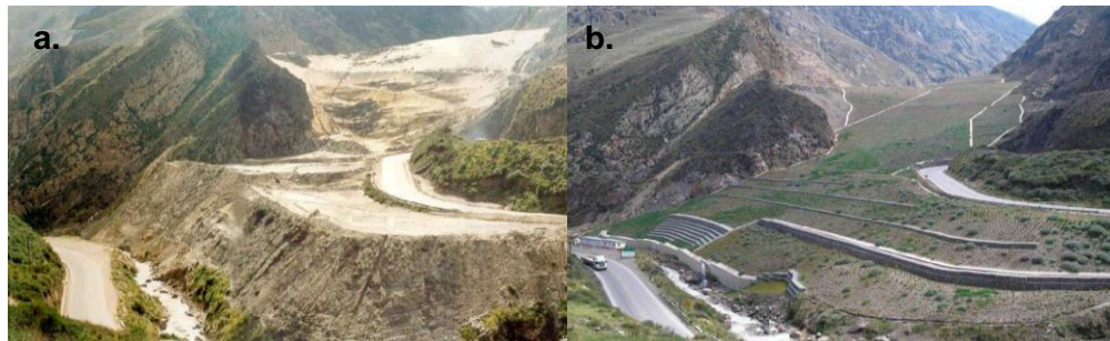
Figura 6.8: Depósito de relaves Tablachaca en Perú, a) antes de la remediación y b) después de estabilización de taludes y colocación de cobertura vegetal (Cacciuttolo y Tabra, 2015).
