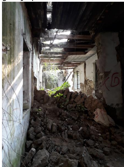
Ilustración 35 Fotografía del estado actual después del sismo de 19 de septiembre de 2017. La casa grande construida en 1907. Fotografía por Zuriel Avila. 3 de enero de 2018.
