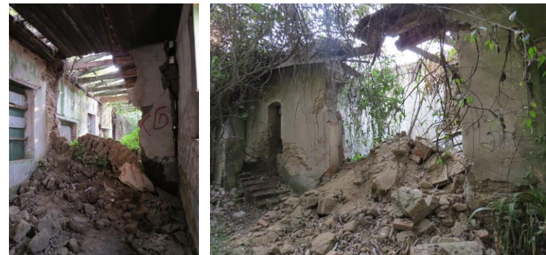
Ilustración 32 Daños post sismo del 19 de Septiembre de 2017. Casa Grande Construida en 1907. Fotografía por Zuriel Avila. 3 de Enero de 2018.
