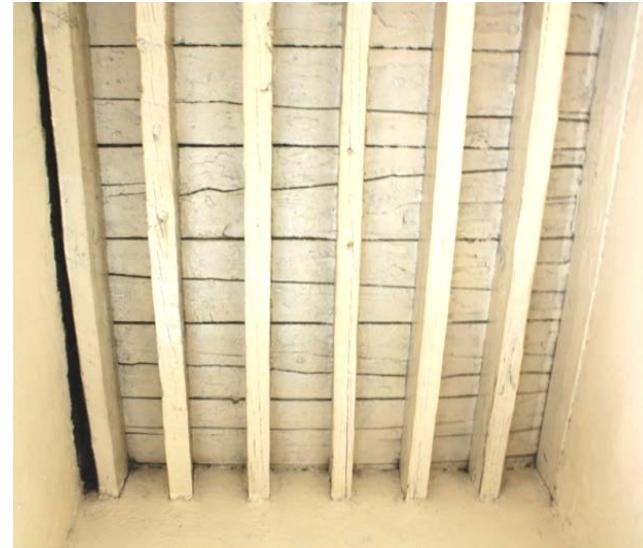
Foto 2. Detalle del techo al interior de un departamento.
