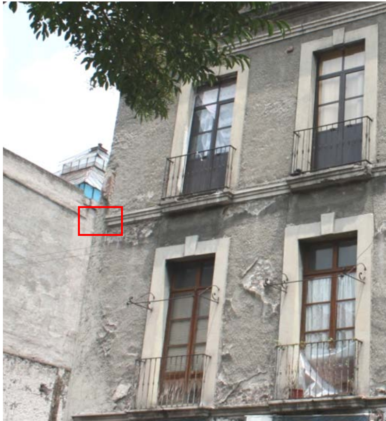
Foto 14. A la izquierda de la foto se puede ver el agregado y la falta del friso en primer y segundo nivel.
