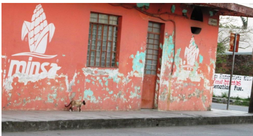
Foto 10: Marcas de humedad en las paredes en El Picamosco Tomada por la autora (16/03/2017)
