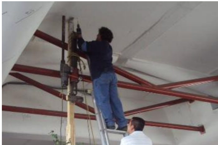
Figura 29. Perforación en la cara inferior de la aleta de la trabe.
