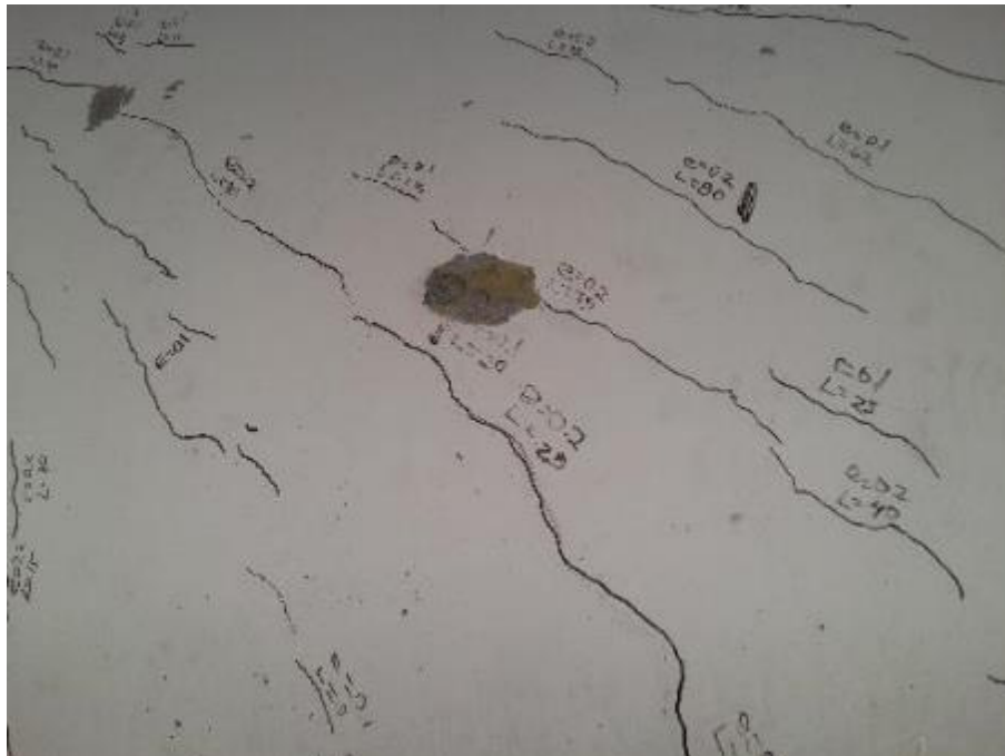
Fig. 18. Detalle de los agrietamientos encontrados en las inspecciones anteriores en las trabes.
