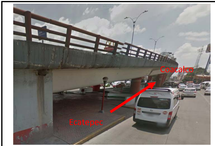
VISTA PANORAMICA- Vista del Cuerpo Derecho con dirección hacia Coacalco. Tramo de acceso a puente en curva. Se observan marcas de escurrimiento en los laterales.
