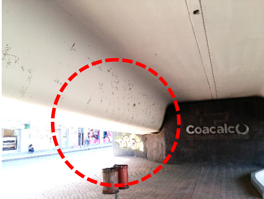
Fig. 17. Agrietamientos localizados en el último tramo suspendido con dirección a Coacalco.
