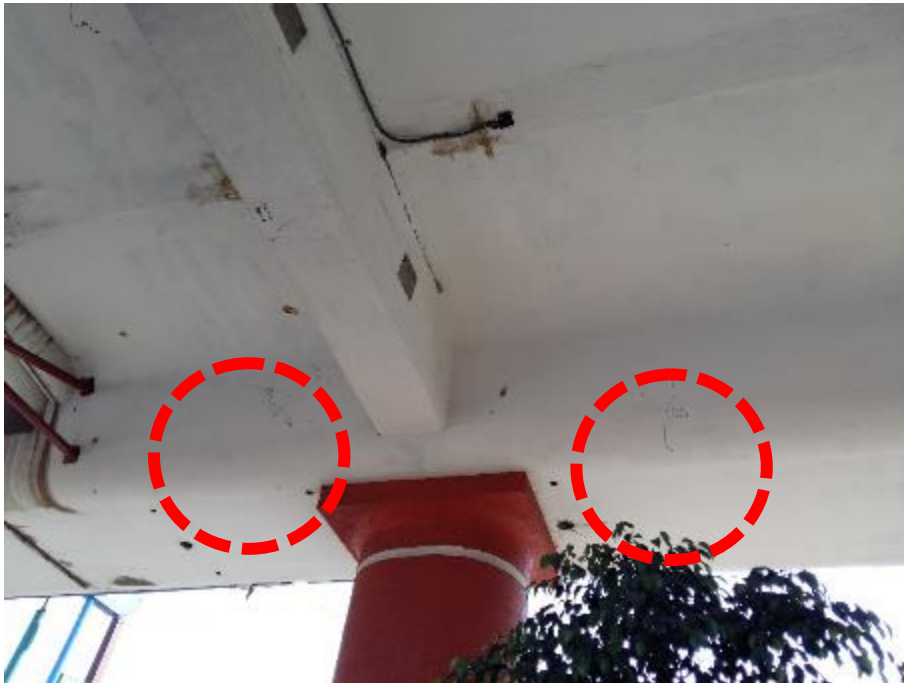
Fig. 20. Vista General de las grietas en las traves sobre columnas.
