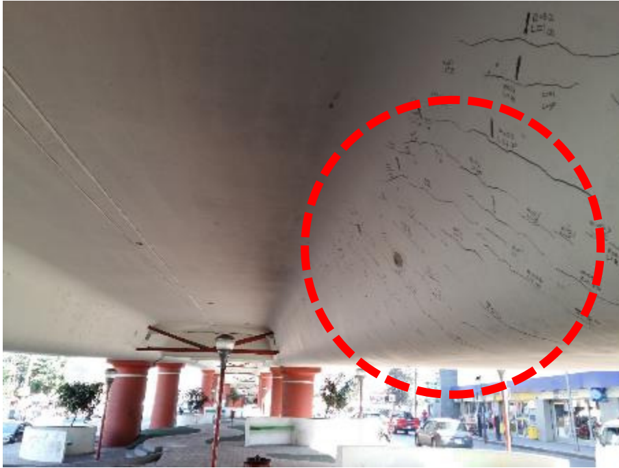
Fig. 19. Otra vista de las grietas ubicadas en el alma de la trabe.
