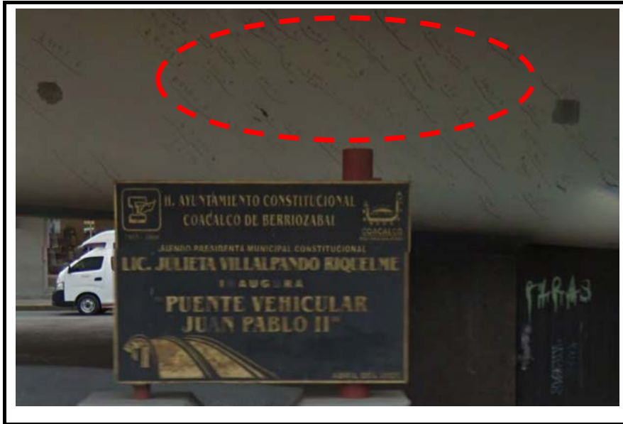
FOTO PANORAMICA.- Detalle de agrietamientos en ultima trabe de tramo suspendido en donde se ubica placa de inauguración del PSV Juan Pablo II.
