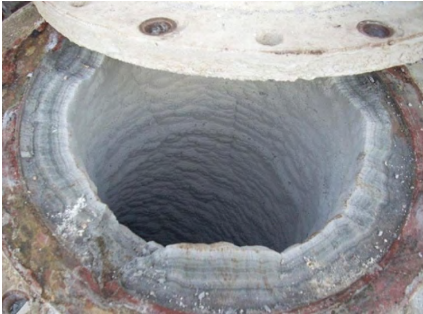
Figura 1. 5.- Incrustación de carbonatos de calcio en una tubería del campo geotérmico Kizildere, Turquía (tomada de Haklidir et al., 2017).
