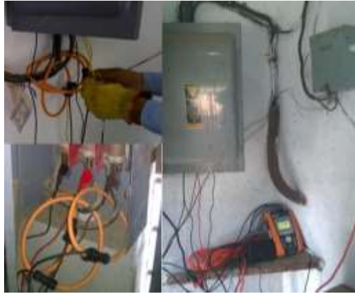
Figura 2-6.- Instalación de Analizador de redes
