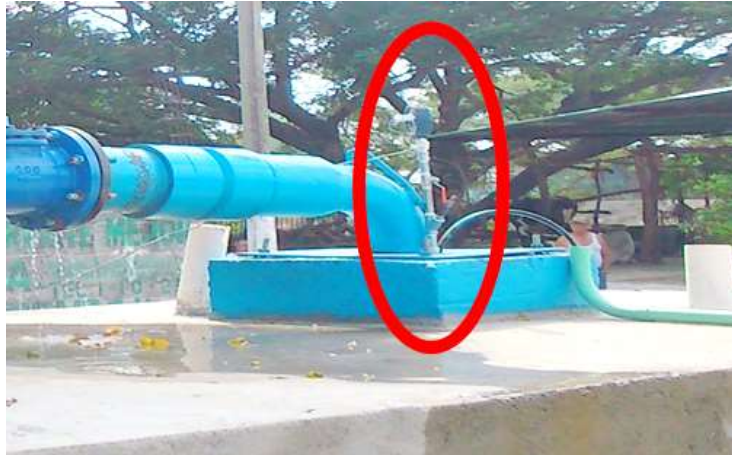
Figura 2-12.- Toma fotográfica de instalación real de manómetro de descarga.
