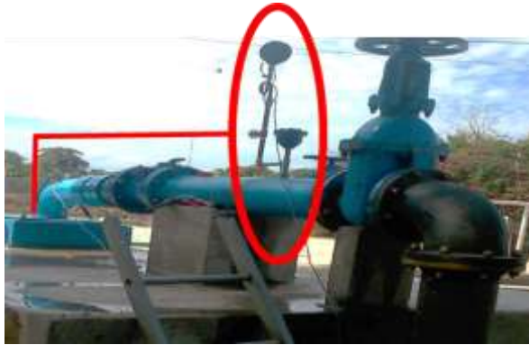
Figura 2-10.- Toma fotográfica de instalación real de manómetro de descarga.
