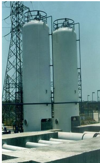
Figura I.15 Cámaras de aire de 11 m de altura y diámetro de 3.4 m (Acueducto el Cuchillo – Monterrey)
