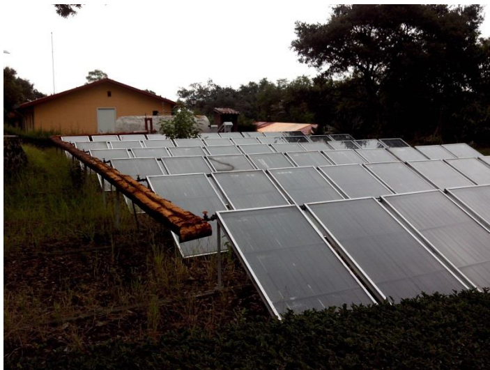
Ilustración 13. Celdas Solares para calentar el agua.
