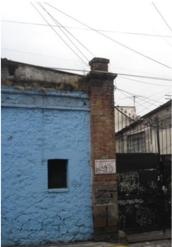
Imagen III 7 Vivienda Obrera para la Fabrica Santa Teresa, Foto tomada por la autora (2017).
