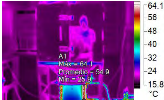
Fig. 202 Captura termográfica del DGA VERTICAL
