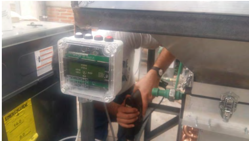
Fig. 174 Panel de control del soplador y los sensores
