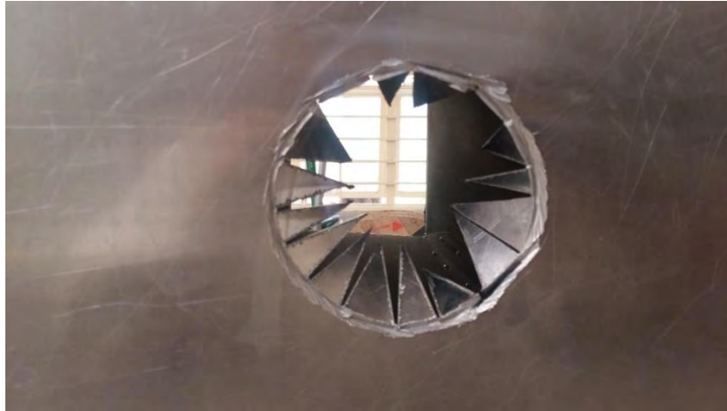
Fig. 90 Corte de la circunferencia medio el uso de esmeril y cortes radiales
