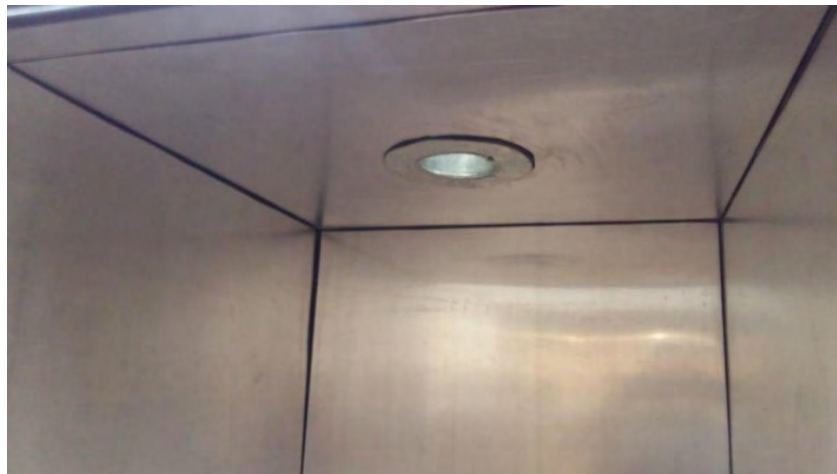
Fig. 92 Vista interna de la chimenea dentro de la cámara, con neopreno como sello
