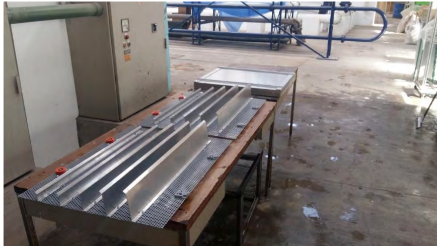
Fig. 188 Desmontaje de componentes para facilidad de limpieza del deshidratador
