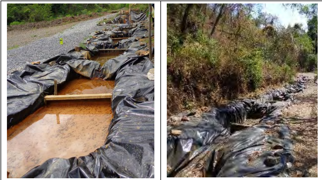
Figura 3. 2. Ubicación del tratamiento pasivo in situ, sistema de piletas (enero 2017)
