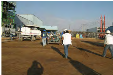
Figura 1.8 Terracería terminada para recibir el concreto sin el uso de base de grava
