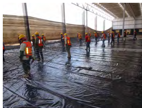
Figura 1.13 Pandeo y desajuste en el acero de refuerzo debido al traslado, razón por la cual debe ser retrabajado y verificado antes del colado
