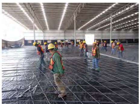
Figura 1.12 Traslado del acero de refuerzo desde el área donde fue habilitado a su ubicación final
