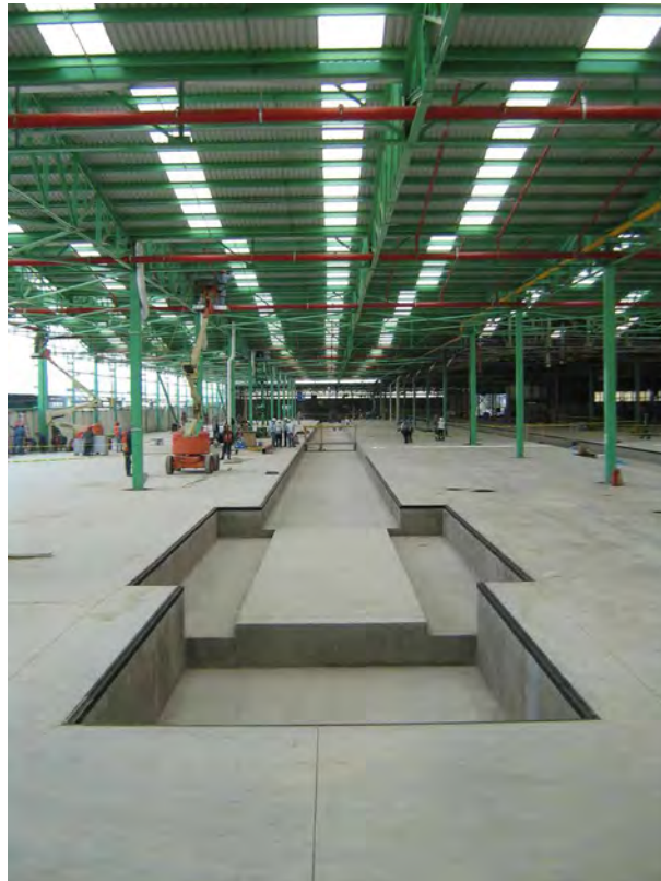
Figura 1.6 Vista interior de la planta de ensamble con pisos y fosas terminados
