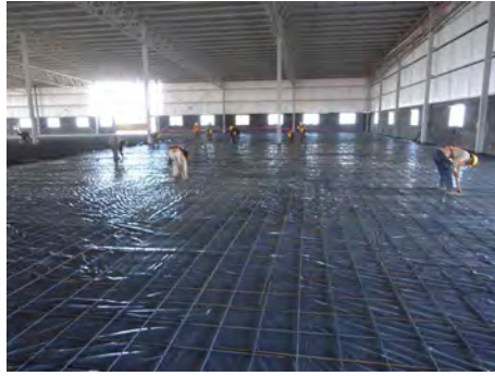
Figura 1.14 Habilitado del acero de refuerzo directamente en la que será su ubicación final
