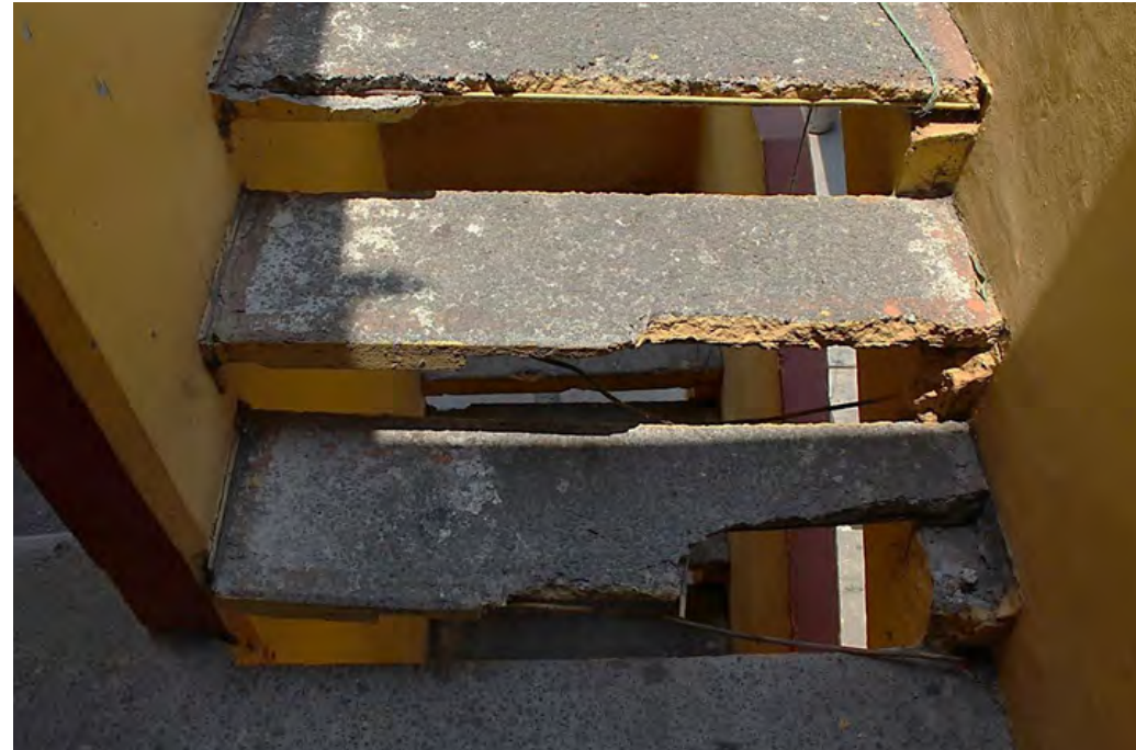
Imagen 4.12. Escalera de acceso a las viviendas del tercer nivel en estado de deterioro.
