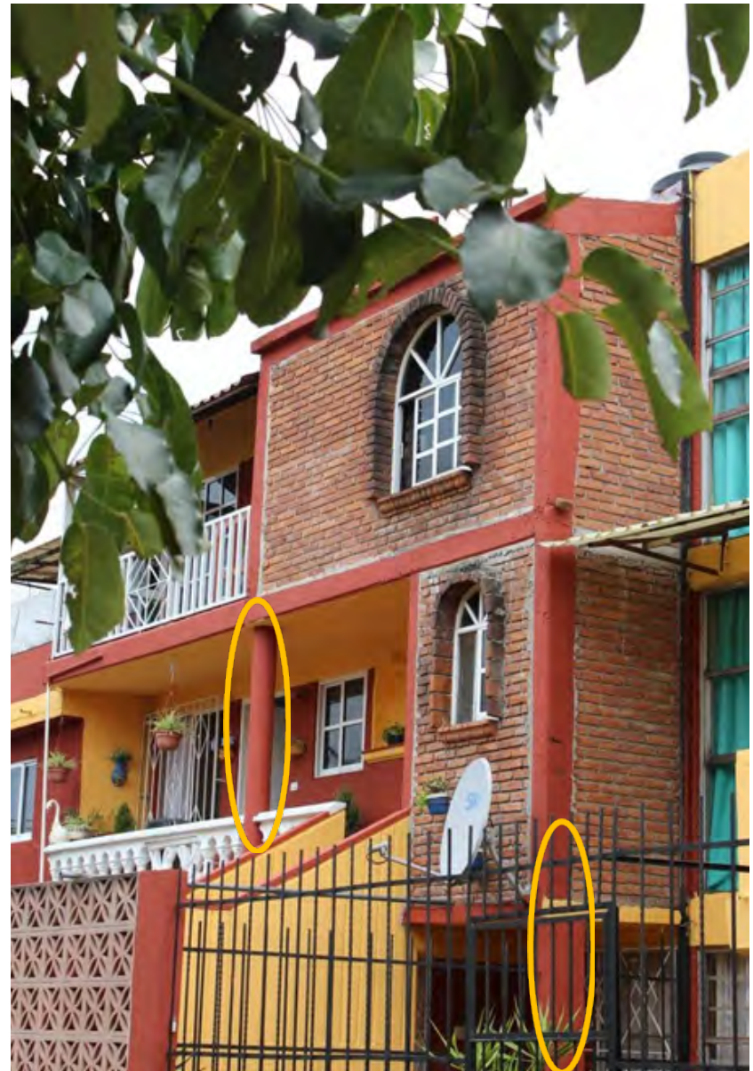
Imagen 3.52. Fotografía del edificio correspondiente al Ejemplo 4 en la cual se marcan las columnas que soportan la ampliación que le hicieron a la vivienda. Fuente: propia 2017
