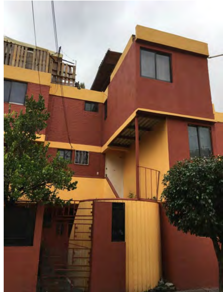
Imagen 3.47. Fotografía en la cual se muestra la ampliación que le hicieron a la vivienda y la columna que se colocó como forma de apoyo. Fuente: propia 2017
