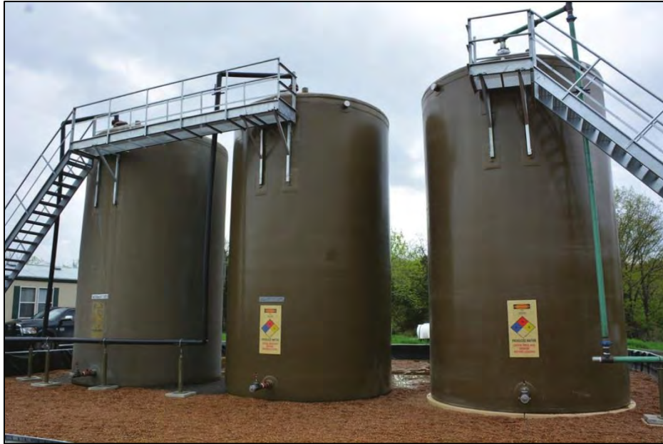
Figura 15 "Tanques de almacenamiento de fluido de retorno"
